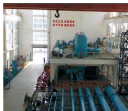
水泵测试中心
